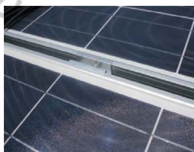
Milieu du champ PV entre modules
