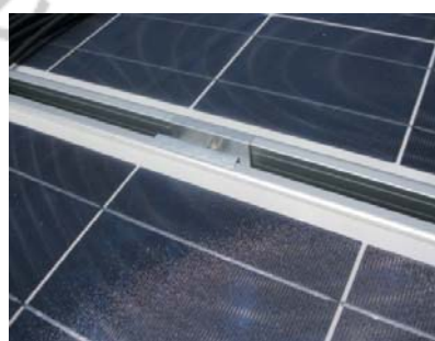
Milieu du champ PV entre modules
