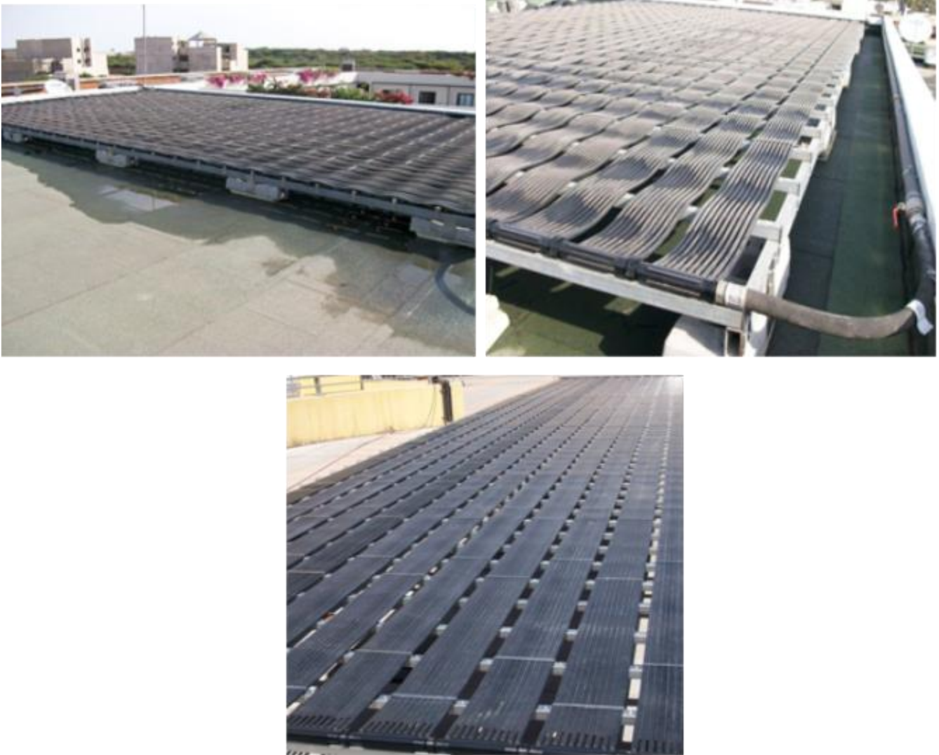
Figure 16 – Photos de capteurs mis en œuvre sur support horizontal
