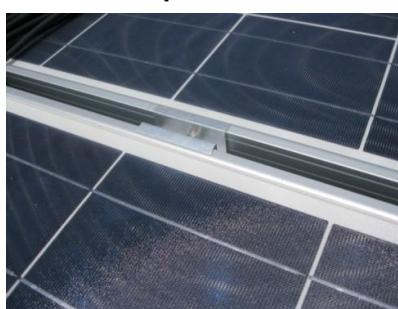
Milieu du champ PV entre modules
