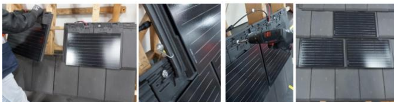
Repetier ces opérations pour chaque FAG 10 Solaire. Suivre le plan de câblage.
