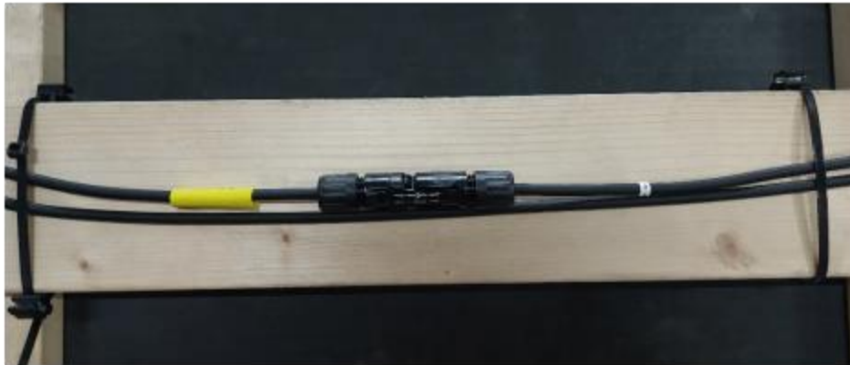
Figure 34 – Cheminement des câbles sous les cadres polymère, sur les planches support et leur fixation par collier de câblage
